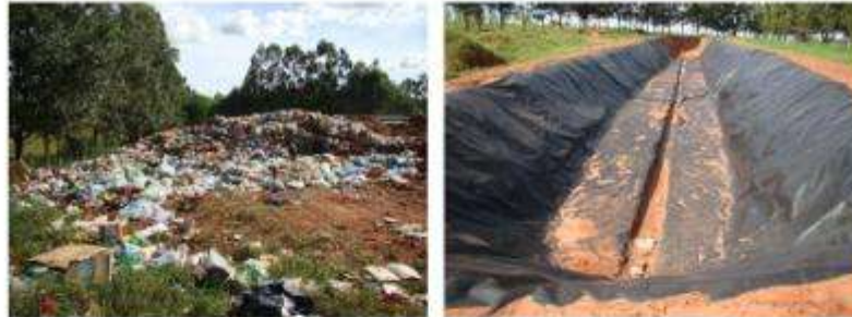
Figura 5: À esquerda acima atual vala que está sendo utilizada para depósito dos resíduos gerados pelos domicílios e comércio. À direita acima vala do aterro sanitário que está pronta para uso
